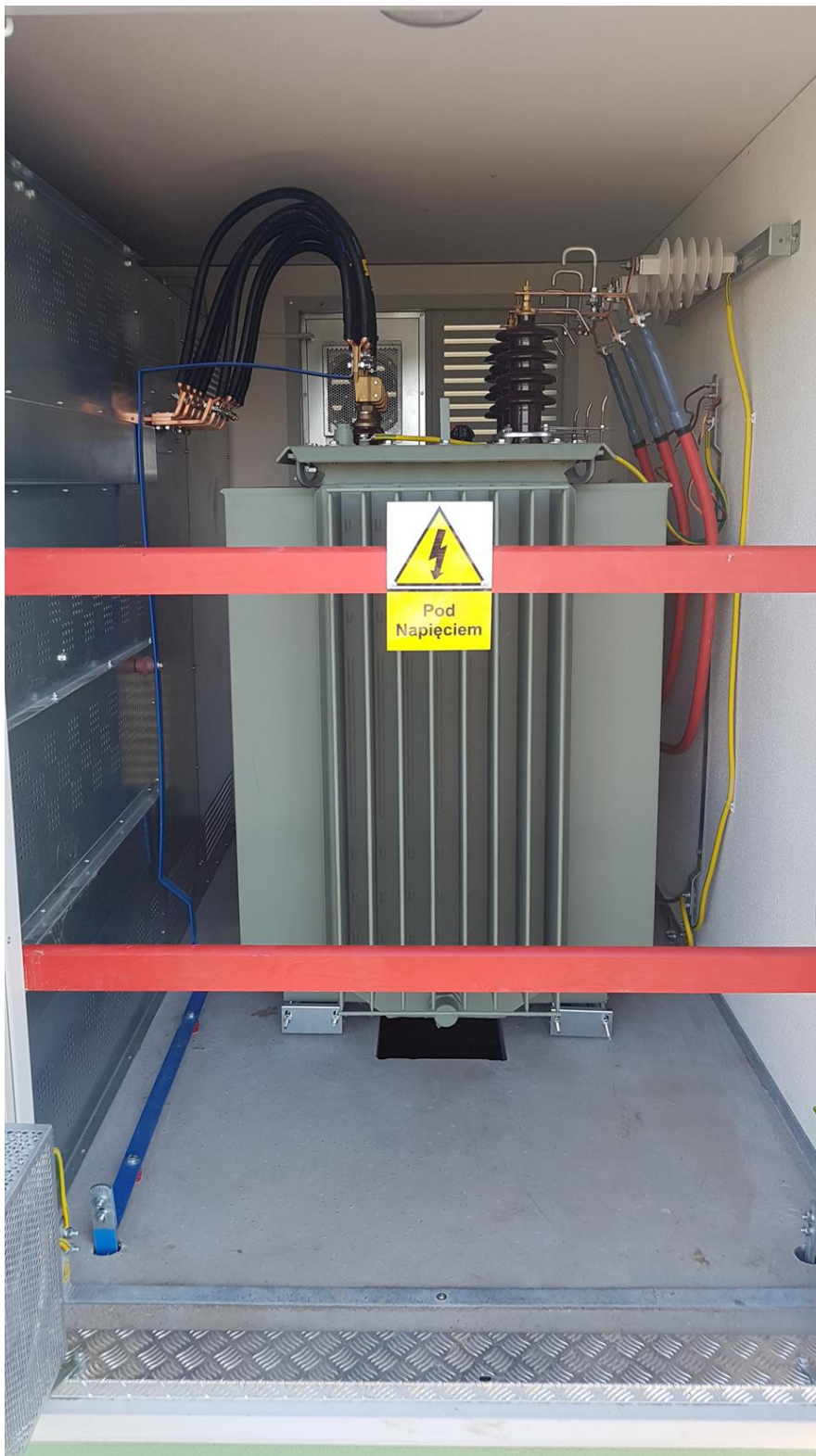
Rysunek 10 Wnętrze stacji transformatorowej o mocy 0,8 MVA
