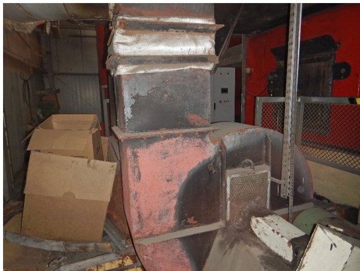
Fot. 5 Widok wentylatora do modernizacji
