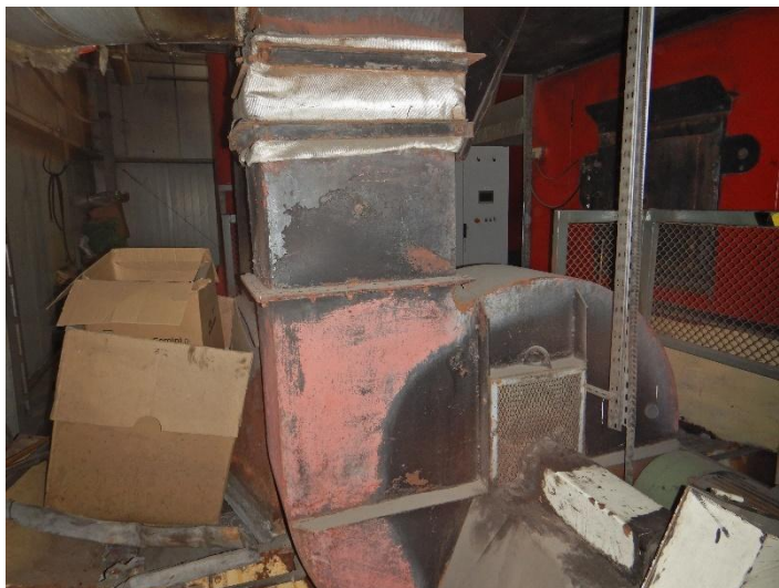
Fot. 5 Widok wentylatora do modernizacji
