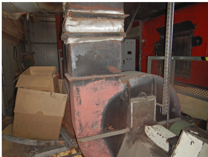
Fot. 5 Widok wentylatora do modernizacji
