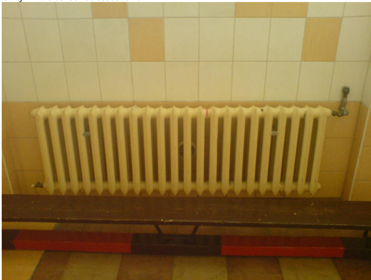
Grzejniki w szatniach do obudowania
